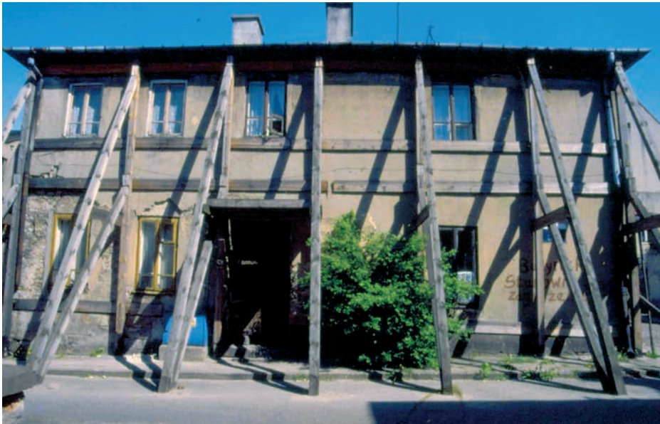
Fot. 4 Przykład zabytku zniszczonego i nieistniejącego: Kielce, dom ul. Kozia 4, uwzględniony w Spisie zabytków architektury i budownictwa , s. 153, grupa IV, poz. 21, rozebrany w latach 90 XX wieku.
