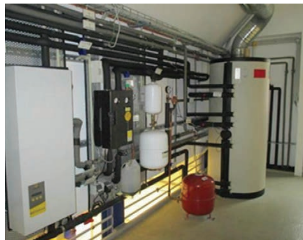
Instalacje domu pasywnego w Centrum Spandau
