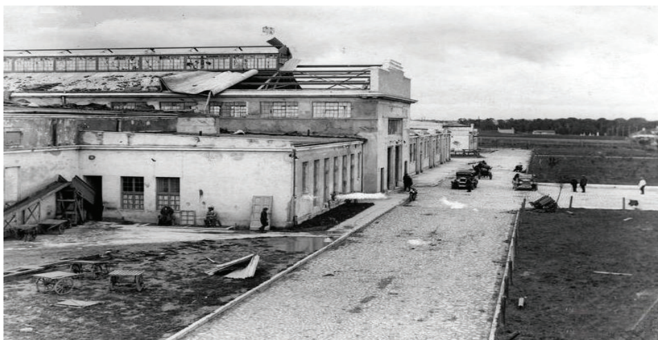
Ryc. 32. Rzeźnia po tornadzie, które przeszło nad Lublinem w 1931 roku nad dzielnicą przemysłową. Zniszczeniu uległo wówczas wiele obiektów, źródło: NAC, sygn. 1-G-2044
