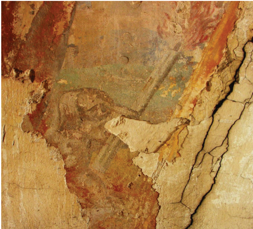
Ryc. 96. Budynek dawnego kościoła, fragment polichromii łuku tęczowego, przedstawienie psa z pochodnią w pysku, oświetlającego drogę św. Dominikowi, fot. K. Janus 2010
