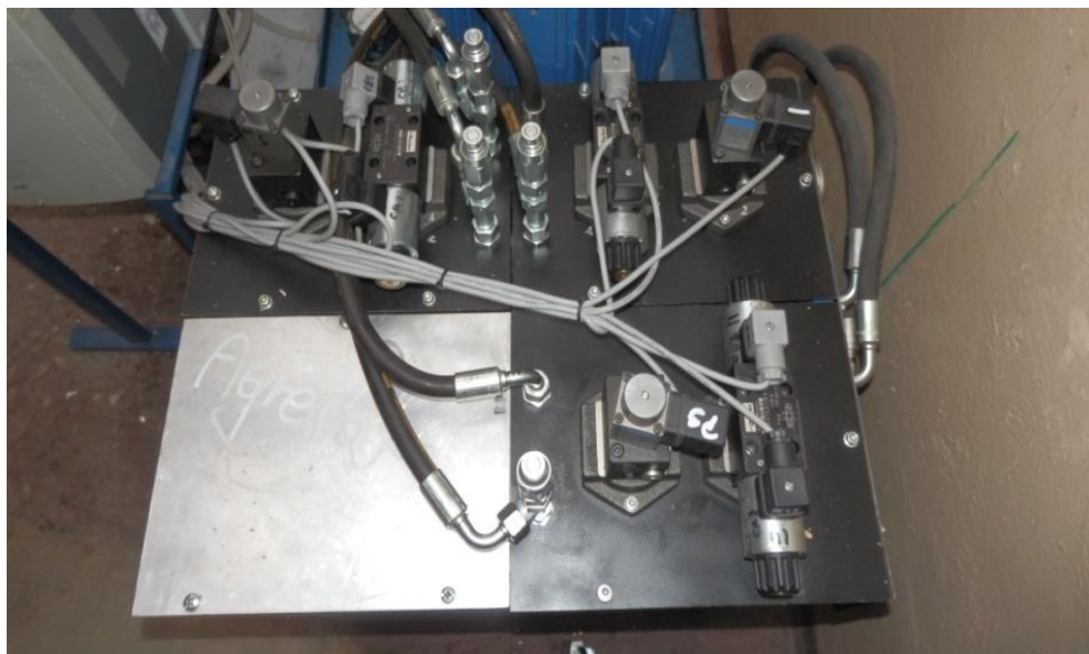
Rys. 6.46. Szybkozłącza zamontowane na przewodach zasilacza hydraulicznego agregatu
