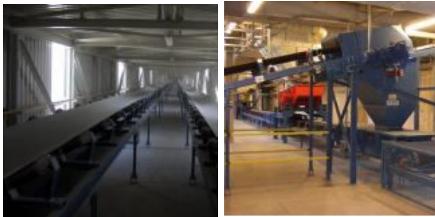
Rys. 5.9. Widok na przenośniki taśmowe [42]
