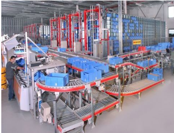
Rys. 8.3. Centrum kompletacyjne bazujące na regałach przelotowych skorelowanych z przenośnikami walcowymi – system SCS [29]
