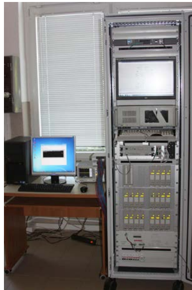
Rys. 7.2. Model laboratoryjny układu regulacji mocy farm wiatrowych wraz z symulatorem systemu oraz układem telemechaniki (opracowano w Katedrze Sieci Elektrycznych i Zabezpieczeń w ramach projektu [B5], wyznaczenie wektora mocy zredukowanych przyporządkowanych poszczególnym farmom jest realizowane zgodnie z opracowaną przez autora iteracyjną metodą śledzenia przepływów)
