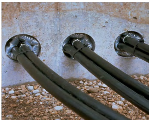
Rys. 17. Wygląd kanałów optotelekomunikacyjnych z tworzywa polimerowego umieszczonych bezpośrednio w tunelach wykonanych z betonu [35]
