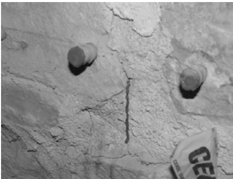
Fot. 10.14 Wyciek zaprawy trasowej z muru
