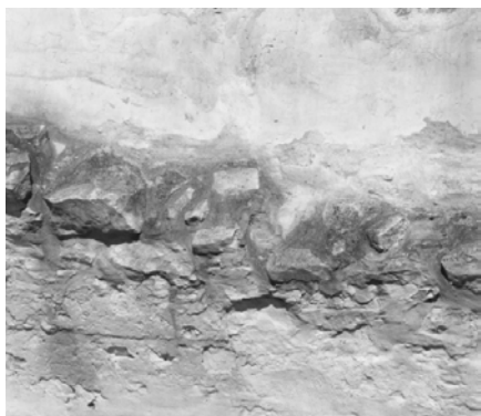
Fot. 3.21 Korozja solna tynków w murze z kamienia wapiennego
