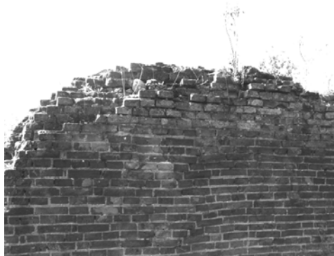
Fot. 3.19 Zniszczenia korony murów z cegły ceramicznej spowodowane działaniem wód opadowych
