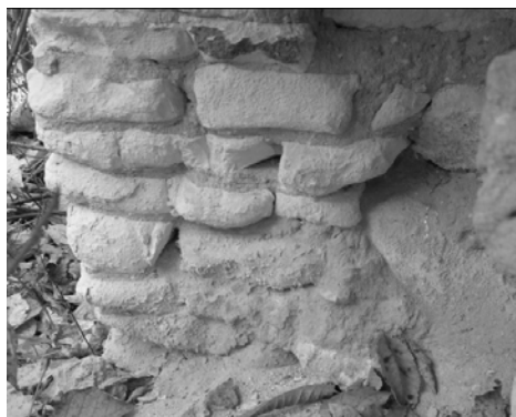
Fot. 3.22 Korozja solna muru z kamienia wapiennego
