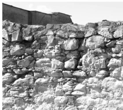
Fot. 3.20 Zniszczenia korony murów z kamienia spowodowane działaniem wód opadowych
