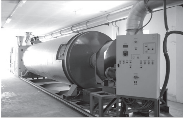
Rys. 31. Suszarka bębnowa (fot. Proeko)
