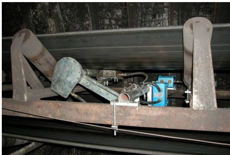
Rys. 5.7 - Zabudowa układu pomiarowego na trasie przenośnika w LW Bogdanka S.A.
