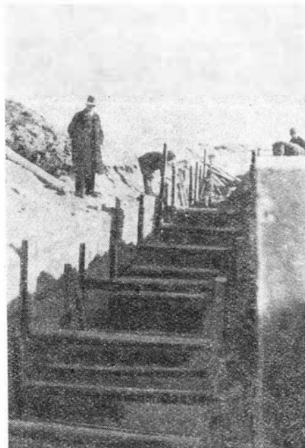
12. Budowa kolektora w Krośnie. Nad wykopem inspektor budowy inż. Marian Pastwa. Zdjęcie ze zbiorów autora (obecnie lotnisko sportowe)
