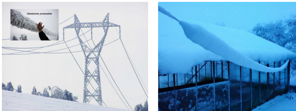
Rys. 8.5. Oblodzenie i sadź na przewodach i elementach konstrukcyjnych linii napowietrznych [18], [56]
