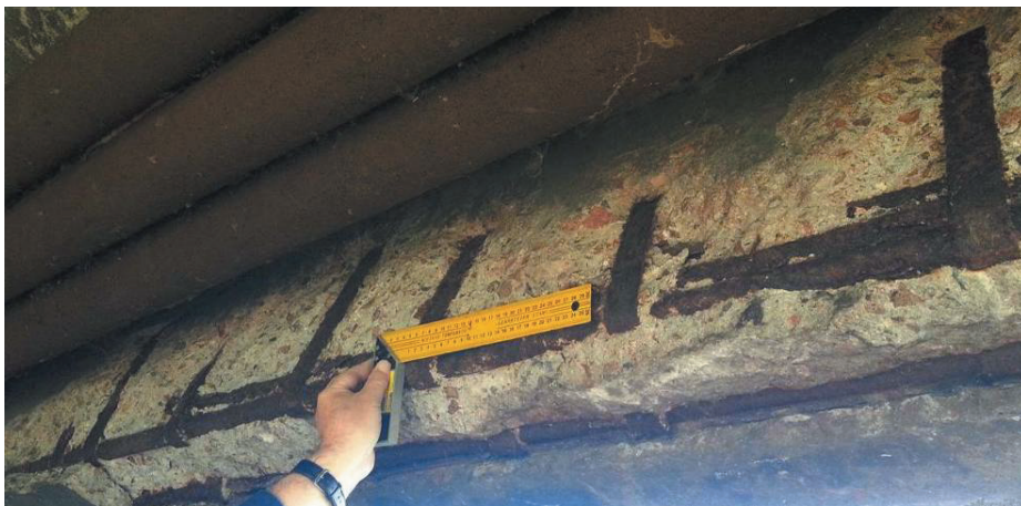
Rysunek 32. Odsłonięcia prętów zbrojenia głównego belki skrajnej, powstałe w 2013 r.
