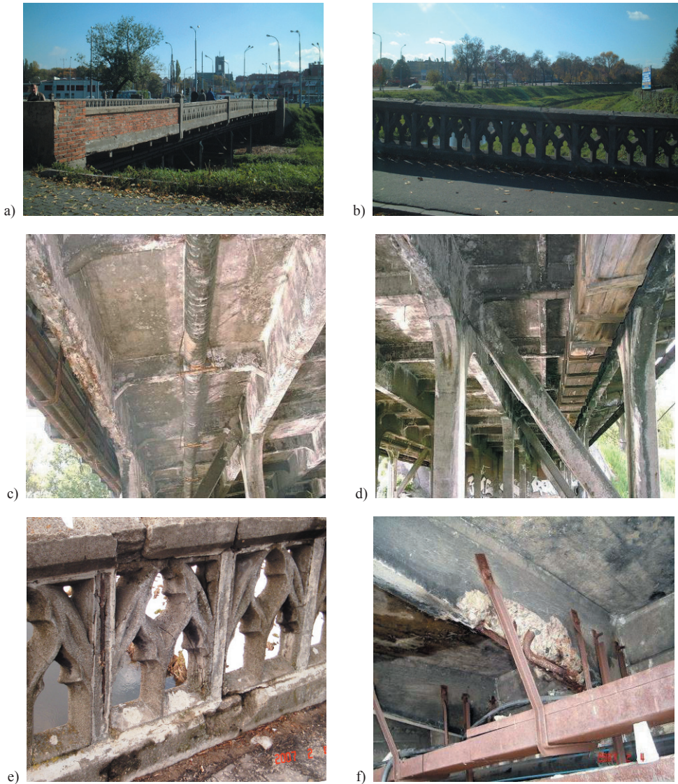
Rysunek 43. Widoki fragmentów mostu, obraz korozji betonu i stali zbrojeniowej: a) tymczasowe wypełnienie balustrady, b) balustrada dla pieszych pozbawiona osłony poręczy i szyszaków, c) odsłonięte zbrojenie główne belki, d) widoczne stalaktydy w miejscach przecieków w pomoście, e) wykruszenie betonu z prefabrykatów balustrady, f) odspojenia betonu, odsłaniające zbrojenie wsporników chodnikowych (2009)
