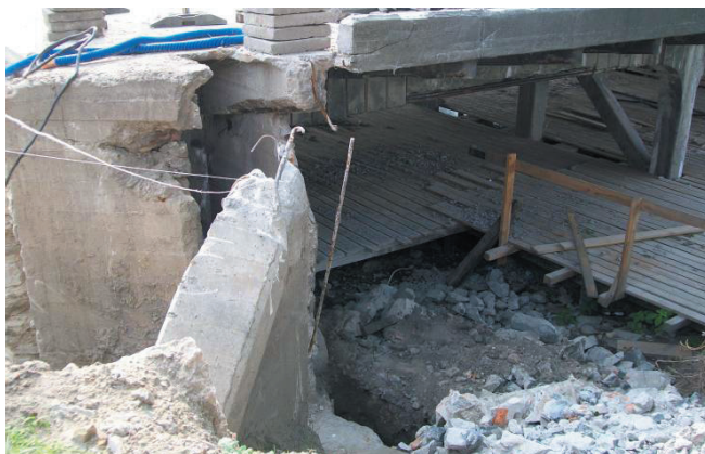
Rysunek 62. Odpady betonowe z różnych fragmentów mostu w ciągu ul. Zamojskiej
