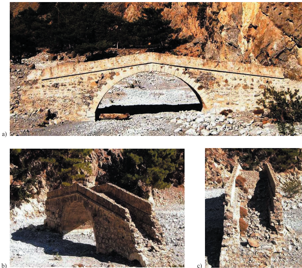
Rysunek 3. Kształtowanie mostu łukowego kamiennego; Samariá, Kreta: a) widok z boku, b) widok aksonometryczny, c) widok wzdłuż mostu
