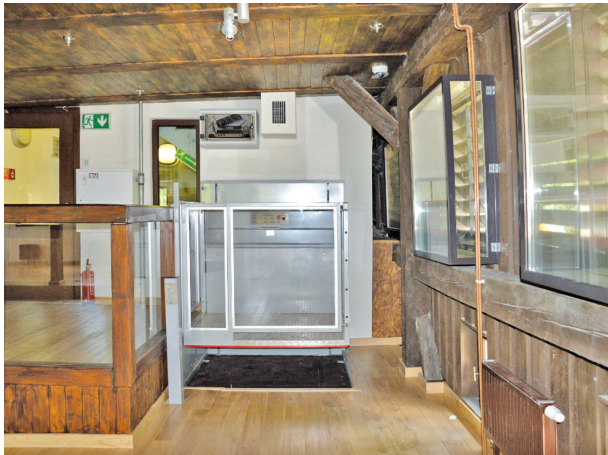
Muzeum Papiernictwa w Dusznikach-Zdroju – różnicę poziomów pomiędzy budynkiem młyna a salami ekspozycyjnych w suszarni pozwala pokonać podnośnik
