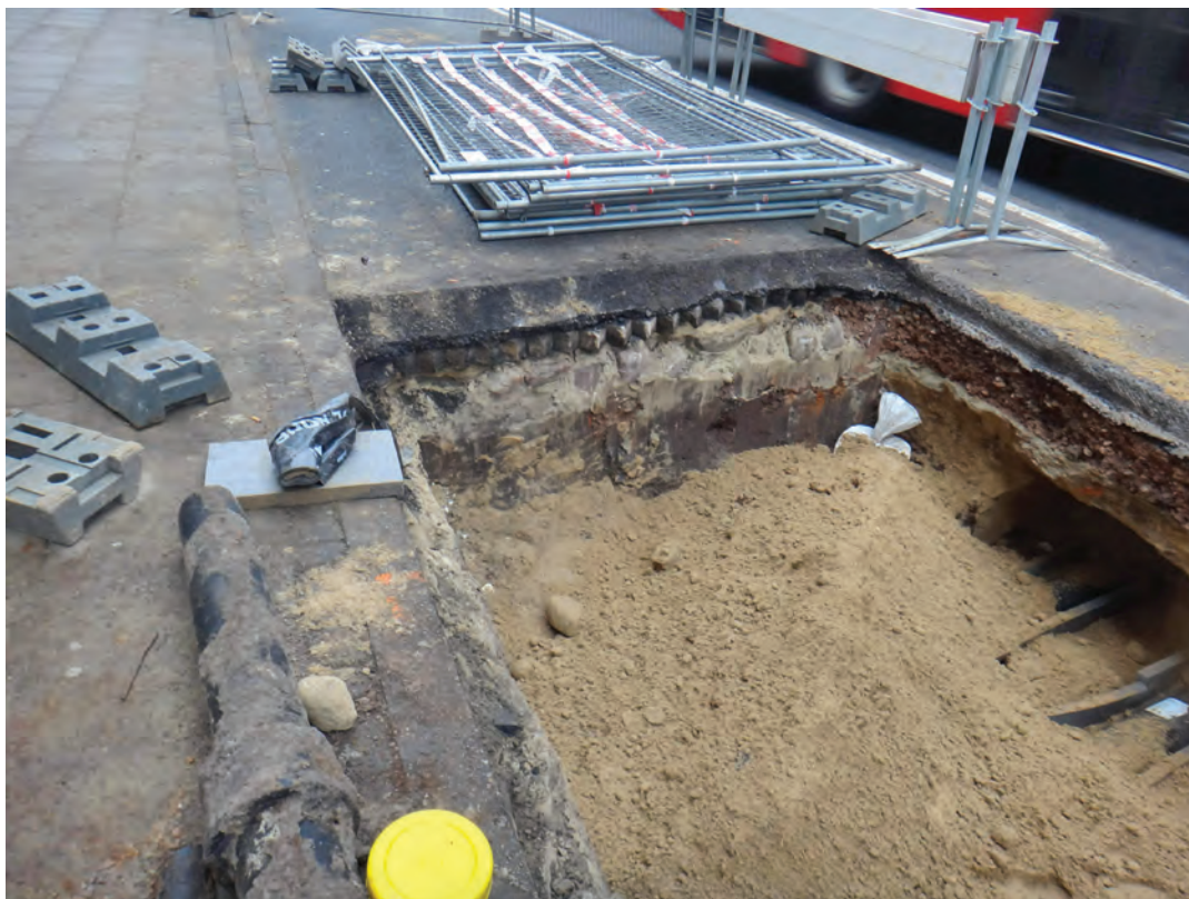
Il. 426. Wykopy pod c.o. na wysokości posesji Bernardyńska 15, poniżej warstw bitumicznych widoczna nawierzchnia z cegł i kamieni polnych, fot. K. Janus, 2015 r.
