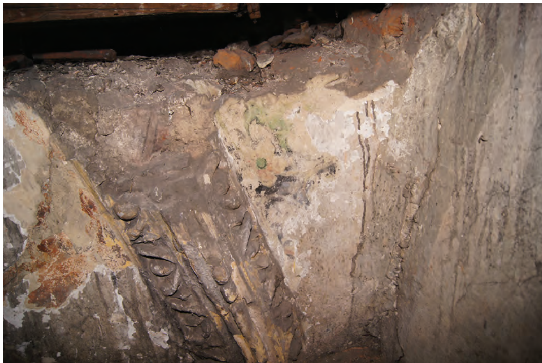
Il. 245. Poddasze nad nawą południową kościoła pobernardyńskiego, fragment zachowanej polichromii zdobiącej sklepienie nieistniejącej wieży, fot. K. Janus, 2012 r.
