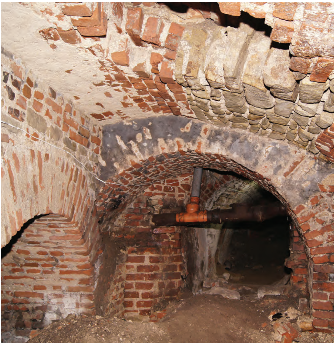
Il. 229. Piwnica pod podwórkiem klasztoru pobernardyńskiego, pomieszczenie 0.06, widok na ścianę południową z fazą narożnika, fot. K. Janus, 2012 r.
