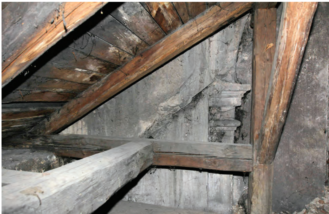
Il. 362. Elewacja południowa nawy kościoła – odcisk (negatyw) starszego dachu (prawdopodobnie sprzed pożaru z 1720 r.), fot. K. Janus, 2017 r.
