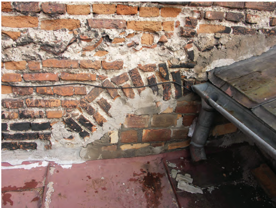
Il. 346. Fragment elewacji prezbiterium od strony południowej z widocznymi osmoleniami cegły, fot. K. Janus, 2017 r.
