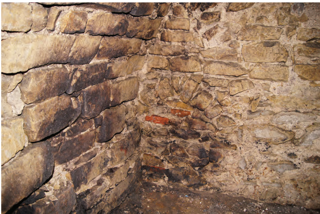
Il. 226. Piwnica klasztoru pobernardyńskiego, zamurowana wnęka piecowa w ścianie północnej, fot. K. Janus, 2012 r.
