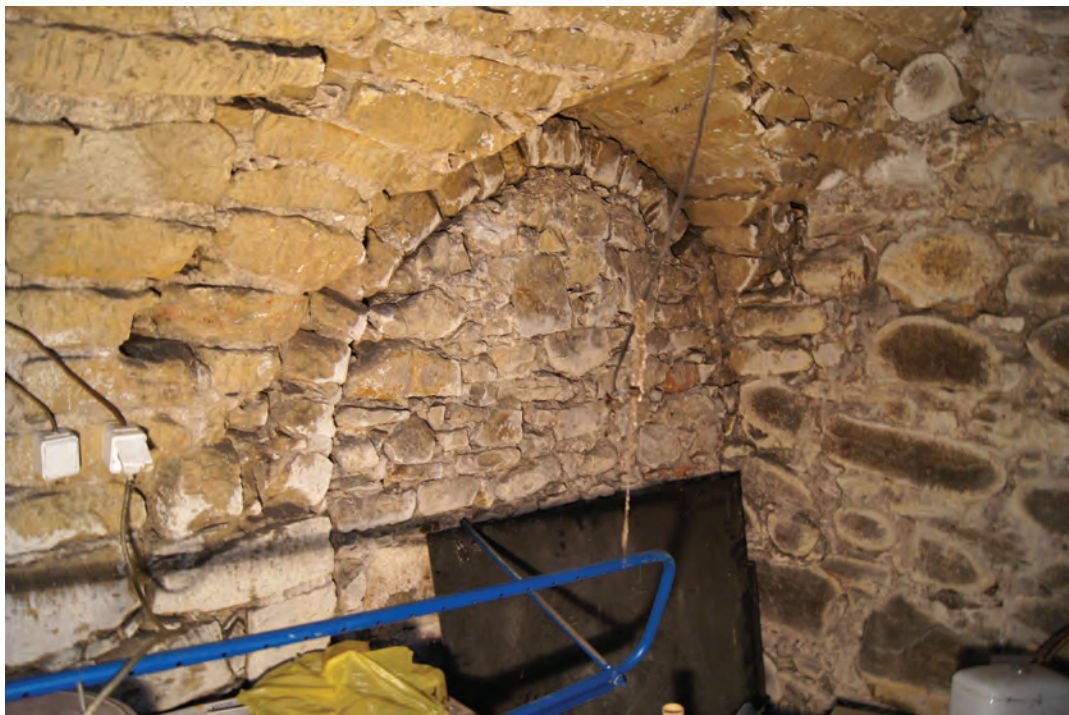
Il. 225. Piwnica klasztoru pobernardyńskiego, zamurowane przejście, fot. K. Janus, 2017 r.
