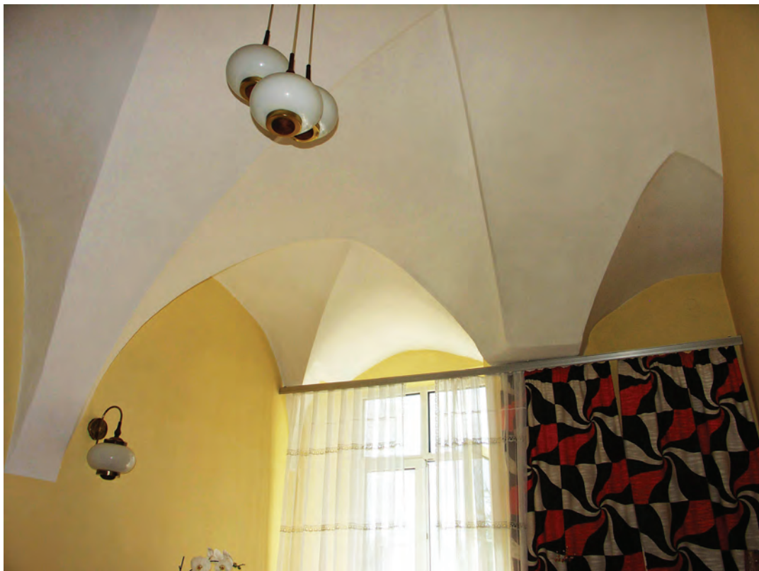
Il. 352. Parter – sklepienie jednego z mieszkań od strony łąk Rusałka, fot. K. Janus, 2010 r.
