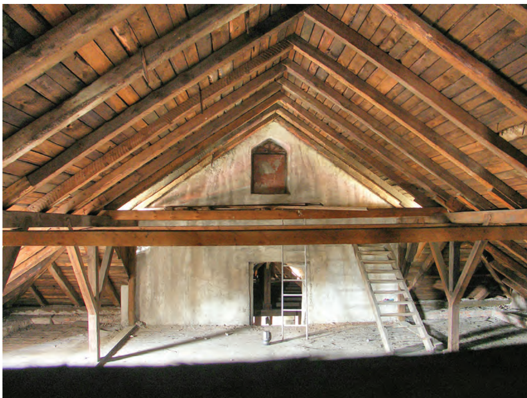
Il. 359. Poddasze nad nawą kościoła, widok na ścianę tęczy, fot. K. Janus, 2010 r.
