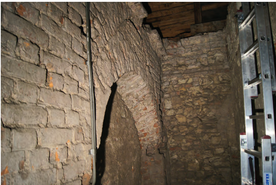
Il. 248. Poddasze ponad przejściem z nawy bocznej do kaplicy kościoła pobernardyńskiego, po lewej widoczne zamurowane okno, ponad nim starszy otwór sklepiony ostrołukowo, fot. K. Janus, 2012 r.
