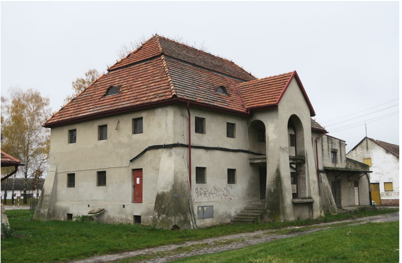
Spichlerz w zespole dawnej Szkoły Rolniczej im. J. Piłsudskiego. Wzniesiony po 1923 r. według projektu Kazimierza Zaremby. Przykład poszukiwań stylu narodowego w architekturze, przez nawiązanie do tradycji dworskiej. Element cennego zespołu zabytkowego oczekującego na kompleksową koncepcję odnowy i zagospodarowania. (fot. A. Siwek)
