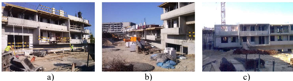
Fot. 5.1 Widok budowy w „fazie 0”: a) segment A, b) segment B, c) segment C
