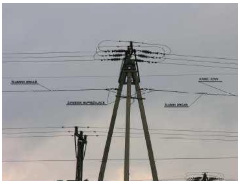
Rys. 9. Przykładowe wykonanie sieci światłowodowej na podbudowie istniejącego słupa linii średniego napięcia
