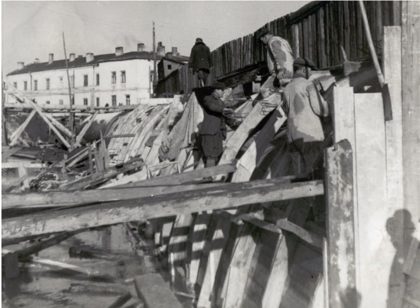
Rys. 83. Prace betoniarskie ostatniego segmentu przesklepienia. Widoczne pręty do ubijania betonu oraz plamy betonu na odzieży robotników. W tle budynek przy ul Sienna 2. Autor nieznany, Kolekcja Jolanty i Wojciecha Jurkiewiczów, 1937
