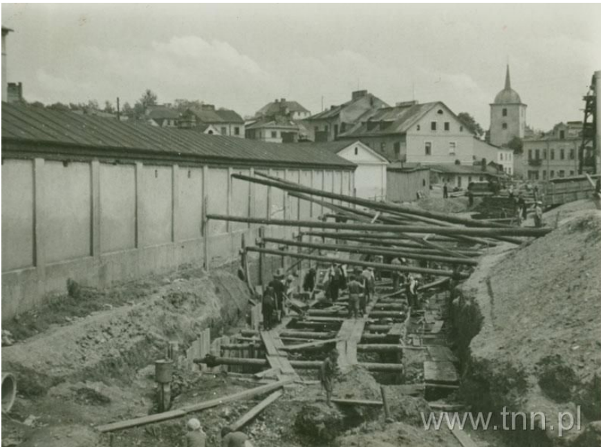
Rys. 90. Prace fundamentowe i zabezpieczenie wykopu podczas III etapu przesklepienia od ul. Nadstawnej do ul. Furmańskiej. Widok w kierunku ul. Nadstawnej. Po lewej jatkę na placu targowym. Autor nieznany, Archiwum Państwowe w Lublinie, wg [87]
