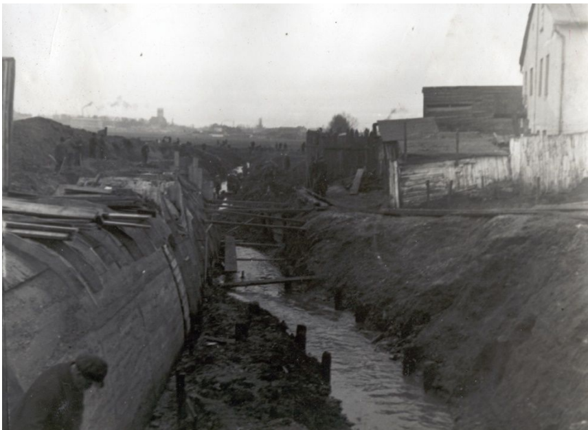
Rys. 84. Ostatni segment przesklepienia. Rozszalowywanie części zewnętrznej. Widok w kierunku Bronowic, po prawej budynek pod adresem Plac Krawiecki 5. Autor nieznany, Kolekcja Jolanty i Wojciecha Jurkiewiczów, 1937
