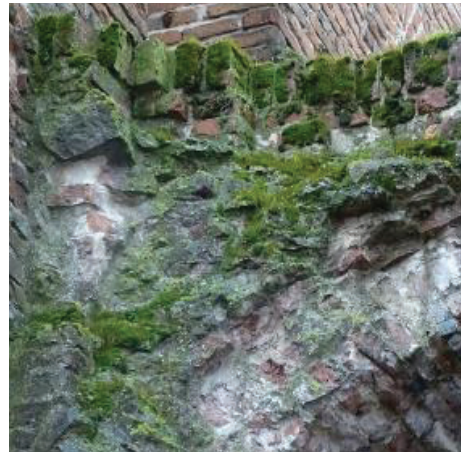
Fot. 27 Porażenie mchami i glonami korony i lica muru
