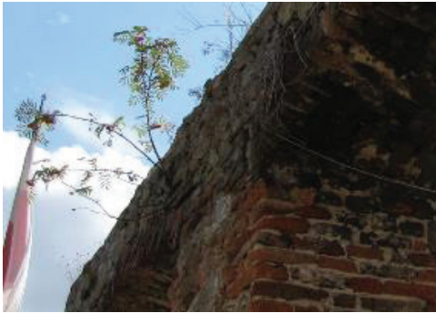
Fot. 36 Jarzębina zakorzeniona w szczelinie pomiędzy murem korony i nadprożem
