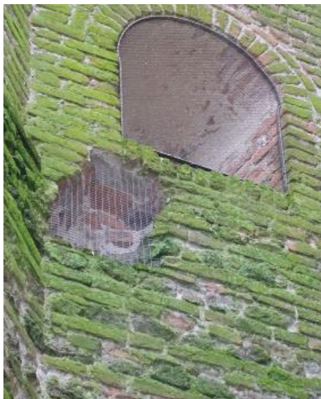
Fot. 22 Kolonie glonów na przewilgoconym murze z cegły ceramicznej
