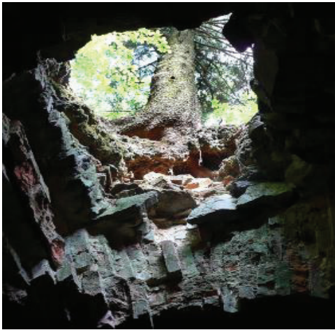
Fot. 38 Uszkodzone przez korzenie sklepienie z cegły ceramicznej
