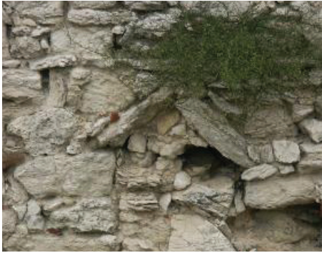
Fot. 28 Fotografia mocno nasłonecznionej elewacji południowej. Rozwój roślinności w szczelinach muru
