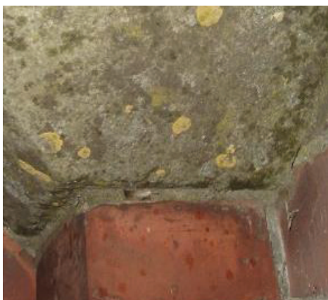
Fot. 24 Porażony porostami fragment tynkowanego sklepienia
