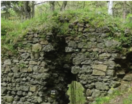
Fot. 32 Całkowicie zarośnięta zielenią niską korona muru. Szczelna warstwa humusu i zieleni uniemożliwia odparowywanie zatrzymanej w murze wilgoci
