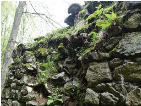
Fot. 30 Porośnięte roślinnością jedno i wieloletnią korona i lico muru kurtynowego
