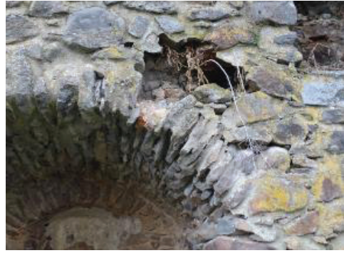
Fot. 29 Uszkodzenie lica muru związane z rozrostem systemu korzeniowego roślinności niskiej
