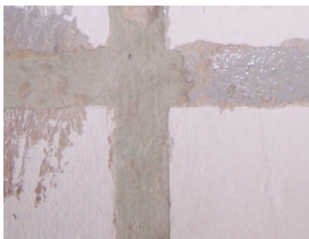
Fot. 20 Odkrywka pasowa z sondami odsłaniającymi spodnie warstw opracowań malarskich
