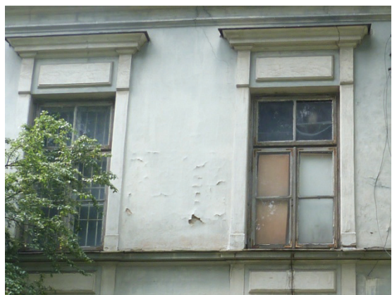
Fot. 4.71. Uszkodzenia tynków i malatur na wysokości piętra
