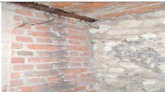
Fot. 4.33. Korozja belki stalowej
