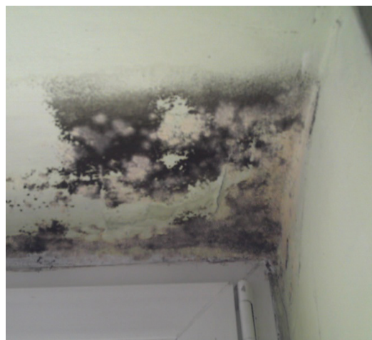
Fot. 4.30. Rozwój grzybów-pleśni w okolicy otworu okiennego [44]
