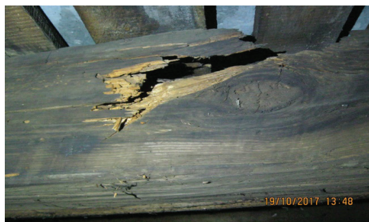
Fot. 4.6 Destrukcja i uszkodzenia krokwi w wyniku działania owadów – szkodników technicznych
