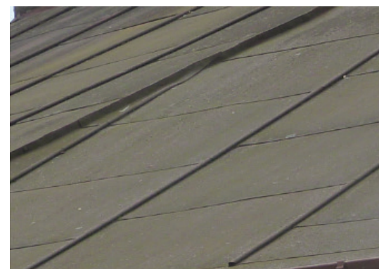
Fot. 4.16. Pokrycie powierzchni dachu korozją biologiczną
