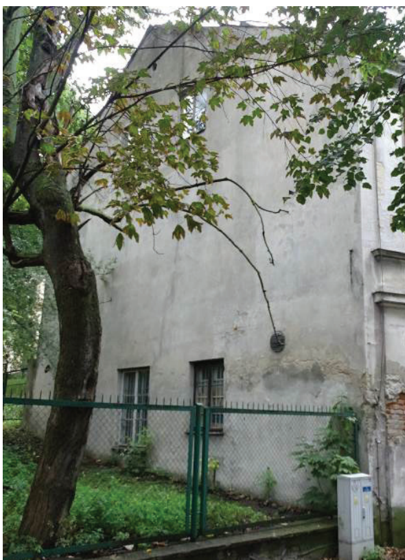
Fot. 4.53. Rysa konstrukcyjna przechodząca przez ścianę szczytową i ścianę piętra
