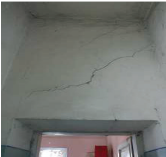
Fot. 4.23. Rysa konstrukcyjna nad otworem drzwiowym [44]
