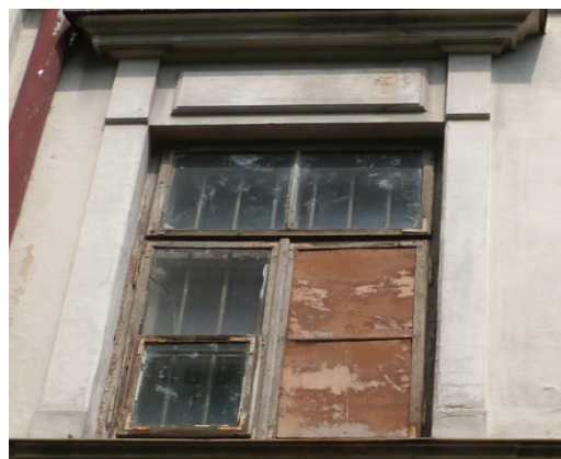
Fot. 4.61. Uszkodzenia stolarki okiennej – odpryski farby, ubytki w szkleniu uzupełnione sklejką
