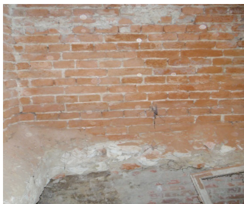
Fot. 4.43. Ściana fundamentowa – widoczne podbicie
