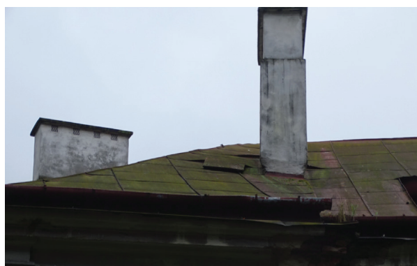
Fot. 4.13. Uszkodzenia rynien i obróbek blacharskich, miejscowo pokrycie porośnięte mchami
