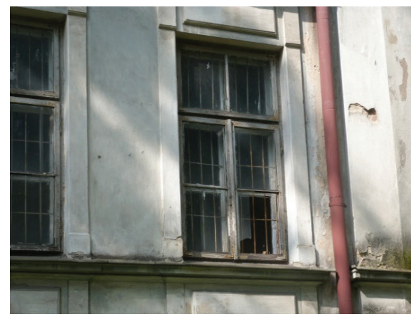
Fot. 4.51. Uszkodzenia ramy okiennej, odprysnięcia malatury, ubytki w szkleniu
