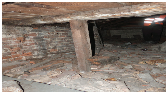
Fot. 4.5. Krokiew porażona przez owady techniczne szkodniki drewna
