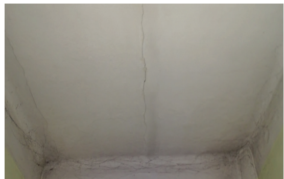
Fot. 4.28. Rysa na stropie, spękania tynków w narożach [44]
