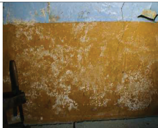
Fot. 4.40. Wykwity solne na powierzchni ściany [44]
