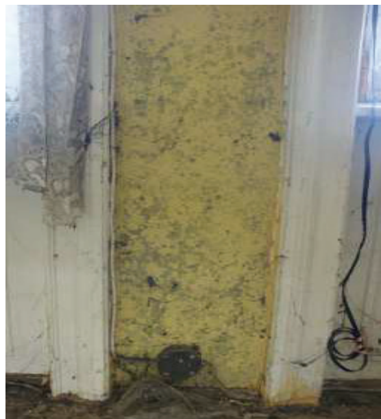
Fot. 4.26. Korozja biologiczna filara międzyokiennego [44]
