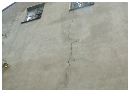
Fot. 4.52. Rysa konstrukcyjna przechodząca przez ścianę szczytową i ścianę piętra
