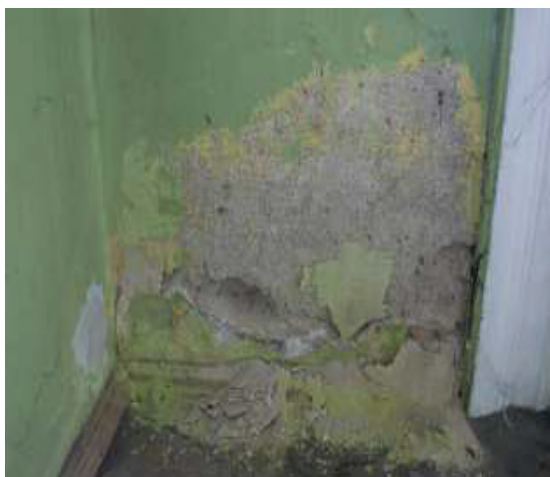
Fot. 4.29. Obsypywanie się tynków[44]
