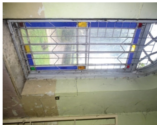
Fot. 4.22. Brak uszkodzeń w stolarnie okiennej klatki schodowej. Odspojenia malatur
