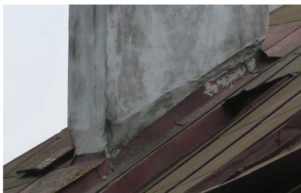
Fot. 4.15. Nieprawidłowo wykonane obróbki blacharskie komina. Korozja elementów
