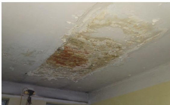
Fot. 4.27. Odsłonięcie konstrukcji stropu na skutek odpadnięcia warstwy tynku
