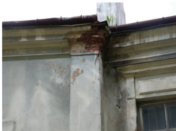
Fot. 4.48. Uszkodzony fragment gzymsu koronującego
