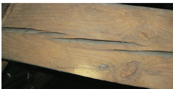
Fot. 4.3. Spękania podłużne krokwi
