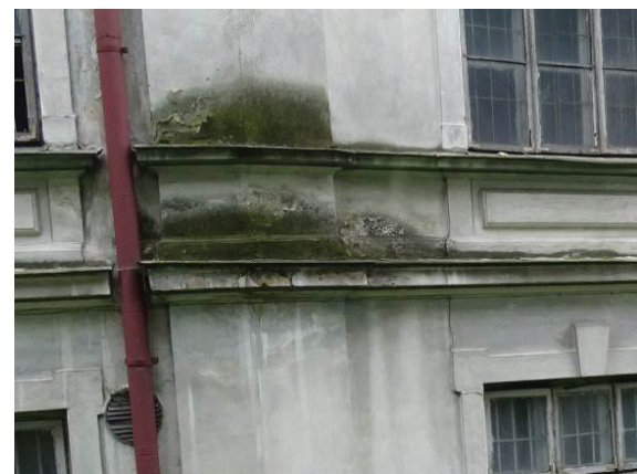
Fot. 4.49. Uszkodzenia tynków murów i detali architektonicznych spowodowane wysokim zawilgoceniem
