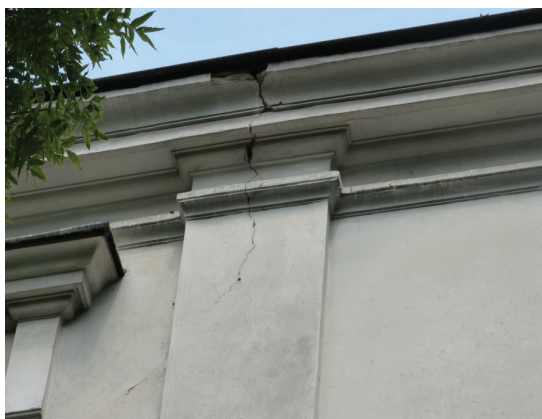
Fot. 4.60. Rysa konstrukcyjna biegnąca od gzymsu koronującego przez pilaster
