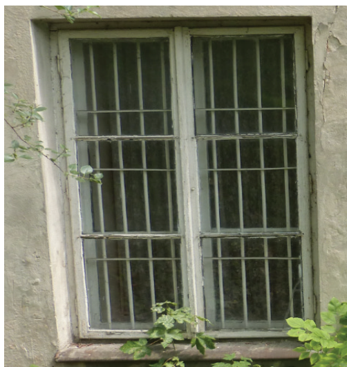
Fot. 4.55. Uszkodzenia stolarki okiennej, odprysnięcia malatur
