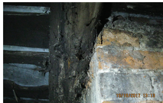
Fot. 4.8. Uszkodzenia krokwi wskutek działania temperatury
