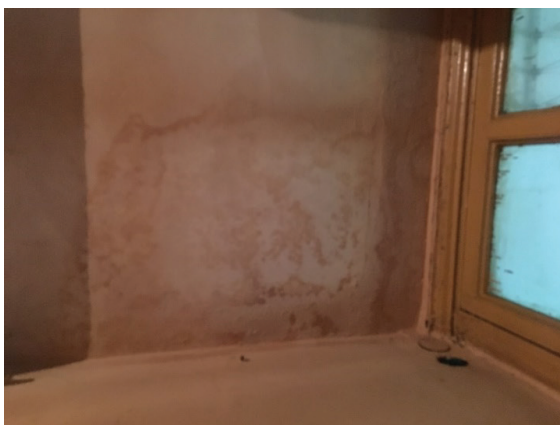
Fot. 4.21. Ślady zawilgocenia występujące na suficie
