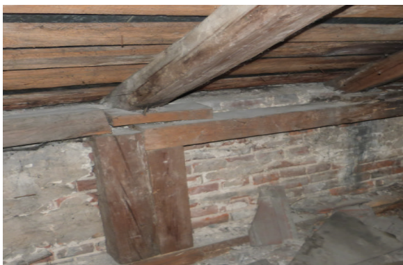
Fot. 4.1. Niewłaściwy sposób oparcia krokwi na murłacie oraz na ścianie kolankowej, objawy zarażenia grzybem domowym krokwi
