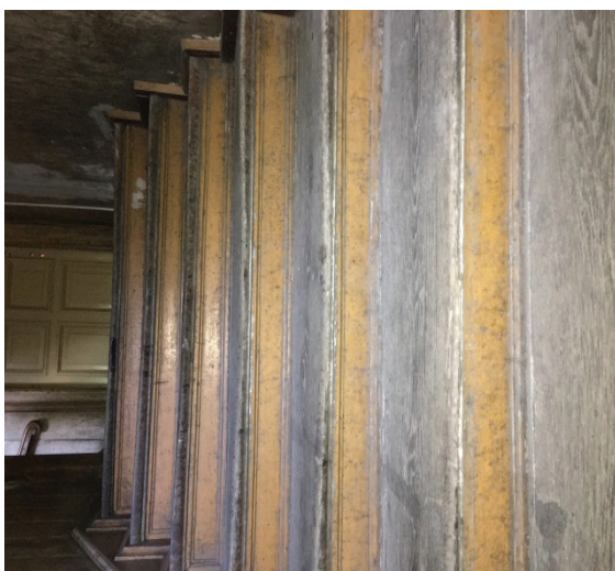
Fot. 4.19. Zużycie eksploatacyjne schodów – wytarcie okładziny
