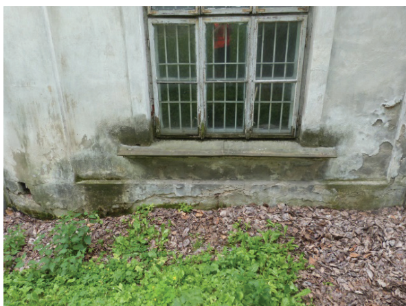
Fot. 4.50. Zanieczyszczenie opaski liśćmi utrudnia odparowanie wody
