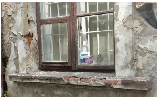
Fot. 4.64. Uszkodzenia obróbki kamieniarskiej okna, wybita szyba w jednym polu, uszkodzenia tynków
