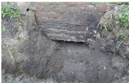
Fot. 4.41. Widoczne podmycie fundamentów, uszkodzenia izolacji powłokowej
