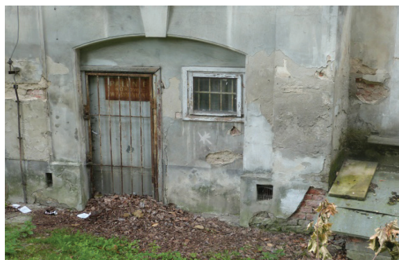
Fot. 4.46. Uszkodzenia tynków w pasie przyziemia spowodowane korozją solną murów
