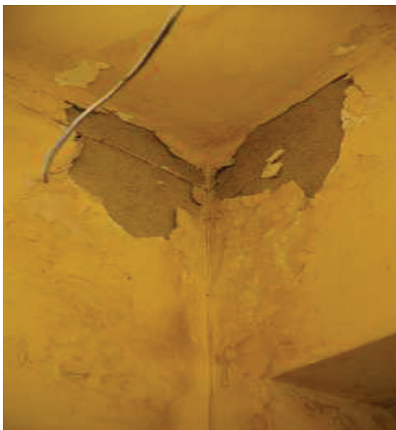
Fot. 4.25. Odspojenia tynków, widoczne ślady zawilgocenia ścian [44]
