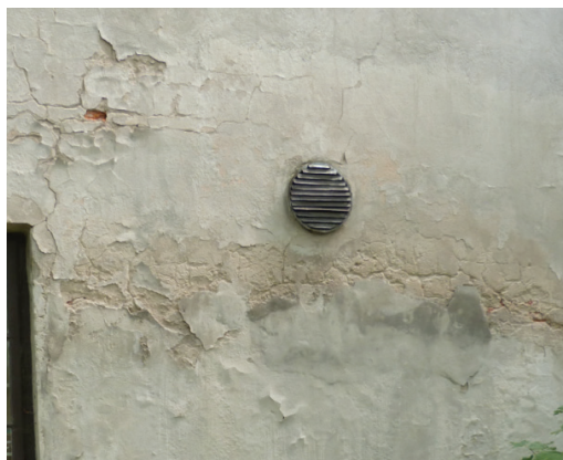
Fot. 4.57. Zdegradowany tynk na wysokości okien parteru
