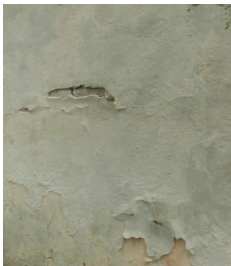
Fot. 4.56. Odspojenia tynków i malatur na powierzchni ściany
