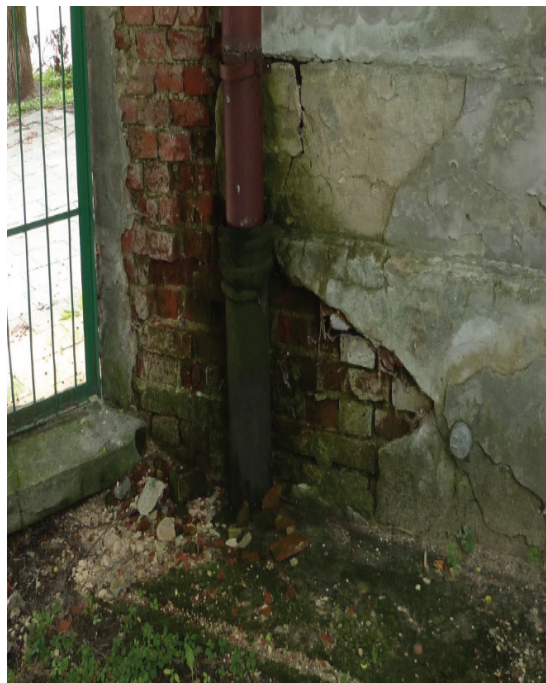
Fot. 4.73. Silna degradacja muru oraz tynków w okolicy nieuszczelnej rury spustowej
