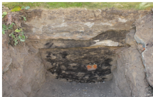
Fot. 4.42. Ściana poniżej poziomu gruntów, uszkodzenia izolacji powłokowej
