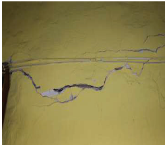
Fot. 4.24. Spękanie ściany między otworami drzwiowymi [44]
