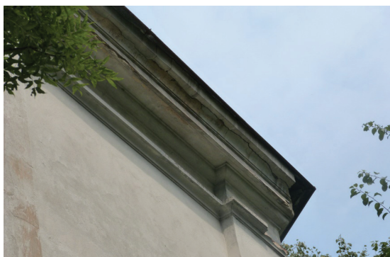
Fot. 4.62. Spękanie gzymsu koronującego
