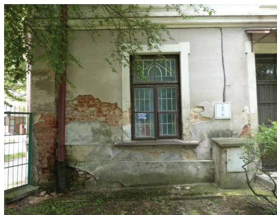
Fot. 4.72. Silna degradacja tynków na wysokości okien parteru
