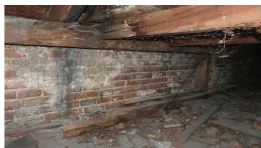
Fot.4.4. Uszkodzenia spowodowane korozją biologiczną, ślady rozwoju grzybów domowych oraz żerowiska owadów
