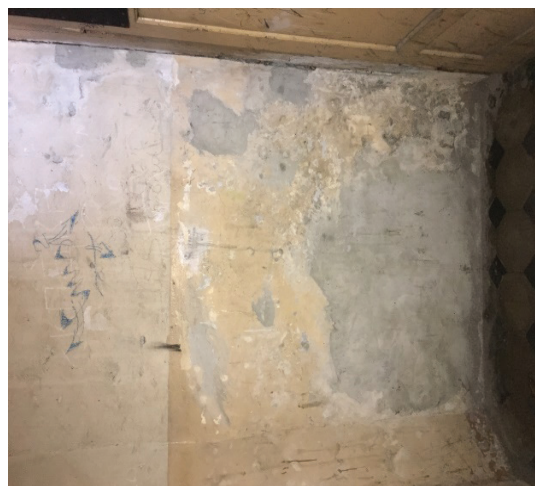
Fot. 4.18. Wtórne uzupełnienia tynków na ścianie, objawy korozji biologicznej w narożu
