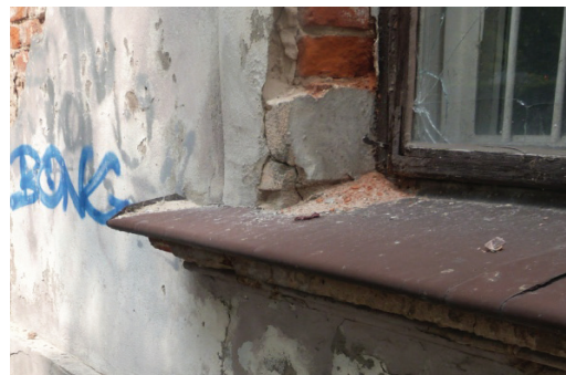
Fot. 4.65. Zardzewiała obróbka blacharska okna, uszkodzenie tynków, pęknięcie szyby
