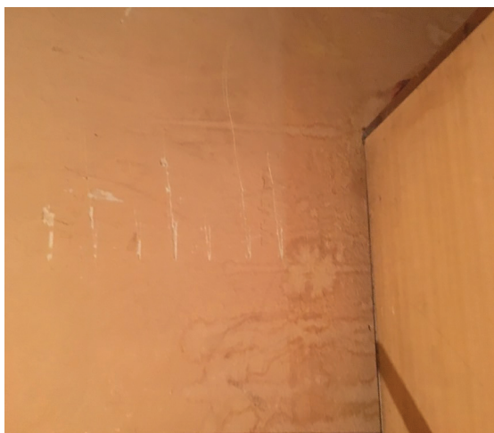
Fot. 4.17. Uszkodzenia mechaniczne ściany. Widoczne ślady zawilgocenia na ścianie
