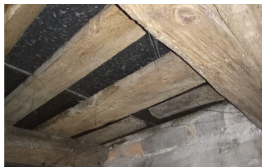
Fot. 4.10. Przecięty element poszycia dachowego
