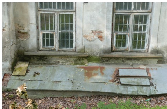
Fot. 4.47. Korozja biologiczna pod parapetami, uszkodzenia tynków
