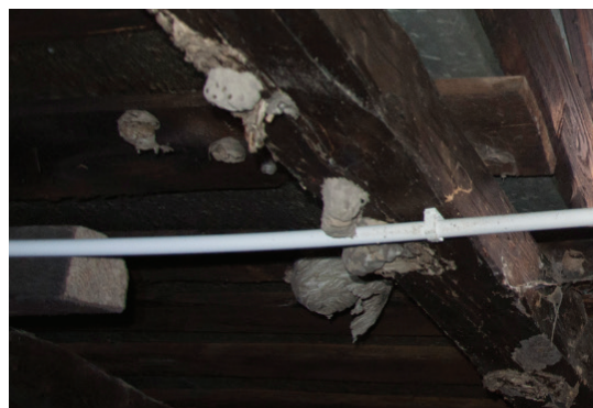
Fot. 4.12. Gniazda os na krokwi w pobliżu nieszczelności dachu
