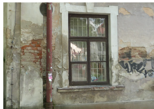
Fot. 4.63. Zniszczenia tynków w pasie odparowania wody podciąganej kapilarnie
