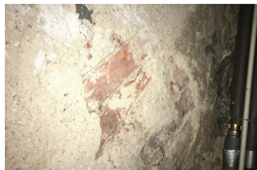
Fot. 4.38. Ubytki tynku, widoczny materiał konstrukcyjny
