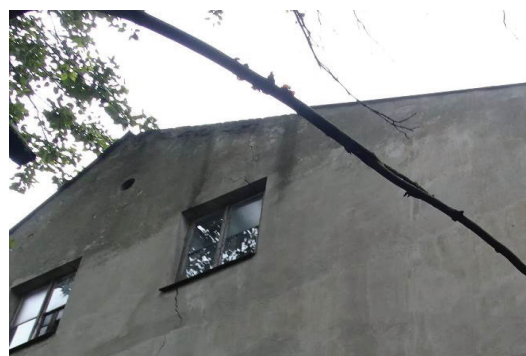
Fot. 4.54. Ubytki obróbek blacharskich szczytu budynku powodujące wnikanie wody opadowej w mury ściany szczytowej
