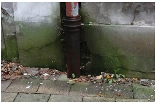
Fot. 4.66. Uszkodzenia cokołu, kolonie glonów w obrębie nieszczelnego połączenia elementów rury spustowej
