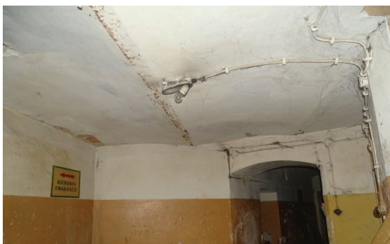
Fot. 4.37. Korozja belki stalowej stropu odcinkowego, ubytki tynku w narożu pomieszczenia
