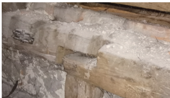
Fot. 4.9. Uszkodzenia połączenia ciesielskiego
