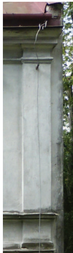
Fot. 3.15. Narożny pilaster na wysokości pierwszego piętra, (u góry znajduje się gzyms koronujący, a na dole fotografii widoczne są gzyms: podokienny i kordonowy)
