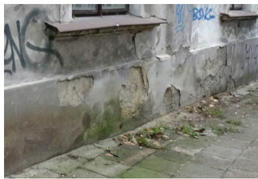
Fot. 4.67. Uszkodzenia tynków cokołu i ścian pod oknami
