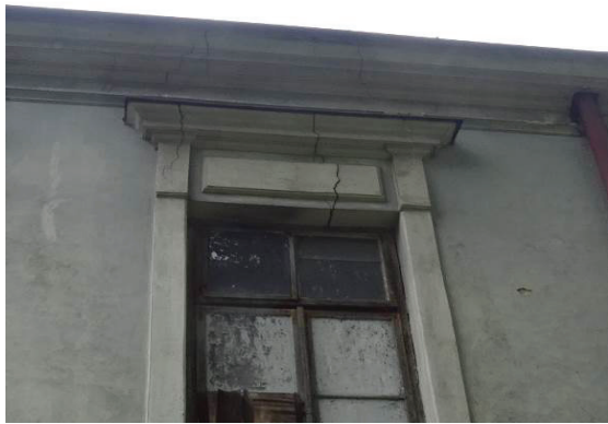
Fot. 4.69. Rysy konstrukcyjne na nadprożach okiennych. Braki w szkleniu uzupełnione płytą pilśniową
