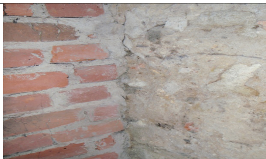
Fot. 4.34. Brak przewiązania ścian
