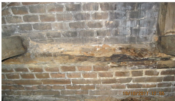
Fot. 4.7. Destrukcyjne działanie rozkładu brunatnego na murłatę
