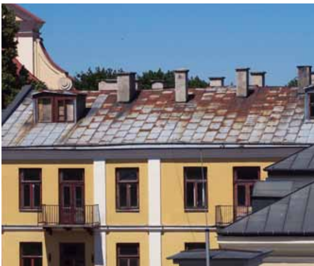
Stan substancji – potrzeby remontowe, dachy i nawierzchnie
