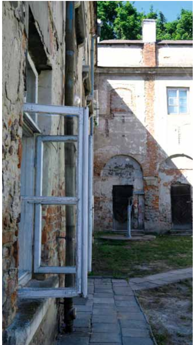
Pałac – widoczna potrzeba prac konserwatorskich
