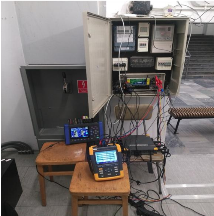
Rys. 1. Stanowisko pomiarowe – rozdzielnia WEiI
