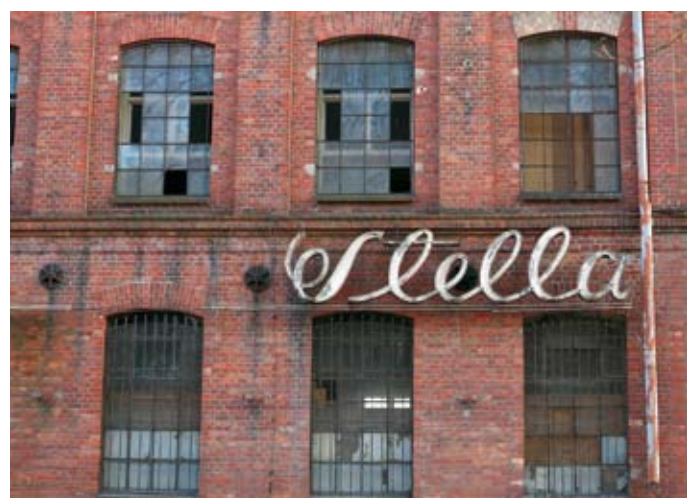
Fot. 61 Fragment elewacji budynku oczekującego na zagospodarowanie, fot. A. Siwek
