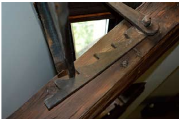
Fot. 53. Kłapy do regulacji natężenia przepływu powietrza. Fot. A. Fortuna-Marek
