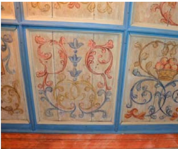
Fot. 44. Fragment dekoracji malarskiej stropu w I pomieszczeniu. Fot. A. Fortuna-Marek
