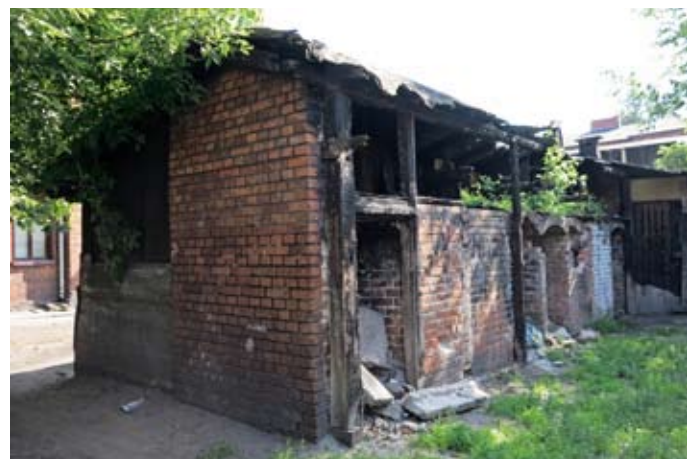
Fot. 59 Zagrożony budynek gospodarczy Fot. A. Siwek
