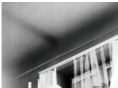
Rys. 3. Typowy przykład zaniedbań właściwych budynkom mieszkalnym
