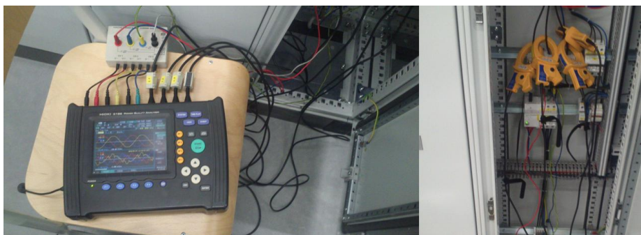
Rys. 1. Analizator Hioki 3196 podpięty do pola zasilanego z paneli fotowoltaicznych (źródło: opracowanie własne)
