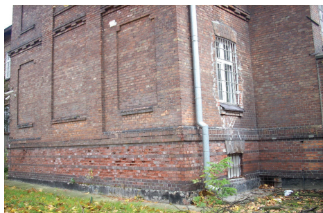
Rys. 5.59. Uszkodzenia muru w wyniku wadliwej hydrofobizacji oraz korozji mrozowej i zasolenia
