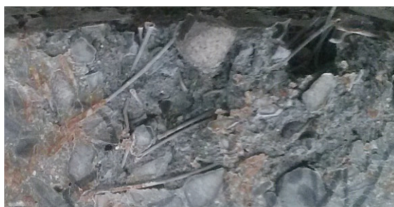
Rys. 5.25. Uszkodzenia próbki SC po badaniu odporności na zamrażanie-rozmrażanie
