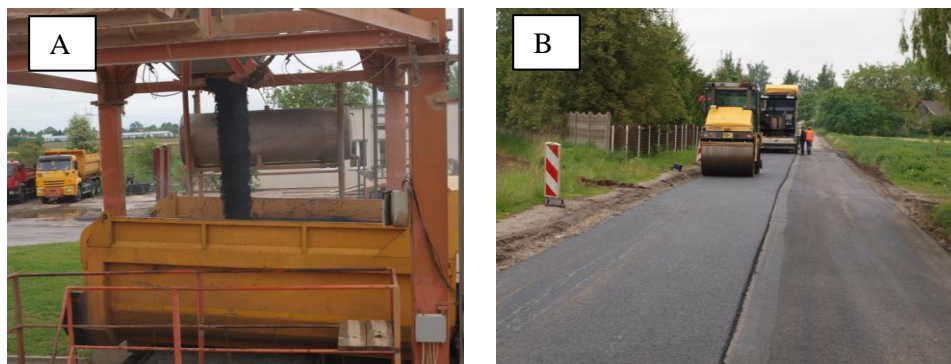
Fot. 6.3. Mieszanka mineralno-asfaltowa 0/16 z dodatkiem zeolitu, przeznaczona do wykonania odcinka doświadczalnego warstwy wiążącej z betonu asfaltowego AC 16 W a) załadunek b) zagęszczanie
