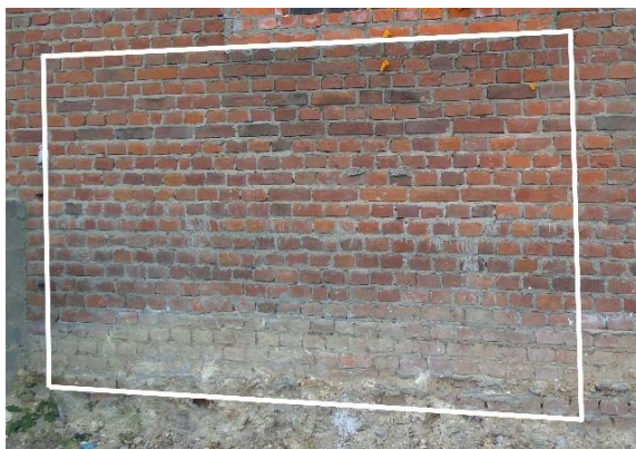
Rys. 3.5.1. Powierzchnia zewnętrzna przegrody (prostokątem oznaczono badany obszar) z wyraźnymi oznakami zniszczenia wywołanymi podciąganiem kapilarnym (źródło: opracowanie własne)
