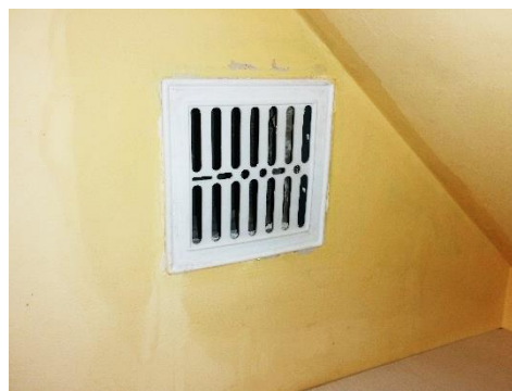
Rysunek 3.5.5. Ścianka w dniu prowadzenia pomiarów, wyraźnie widoczne zacieki wodne
