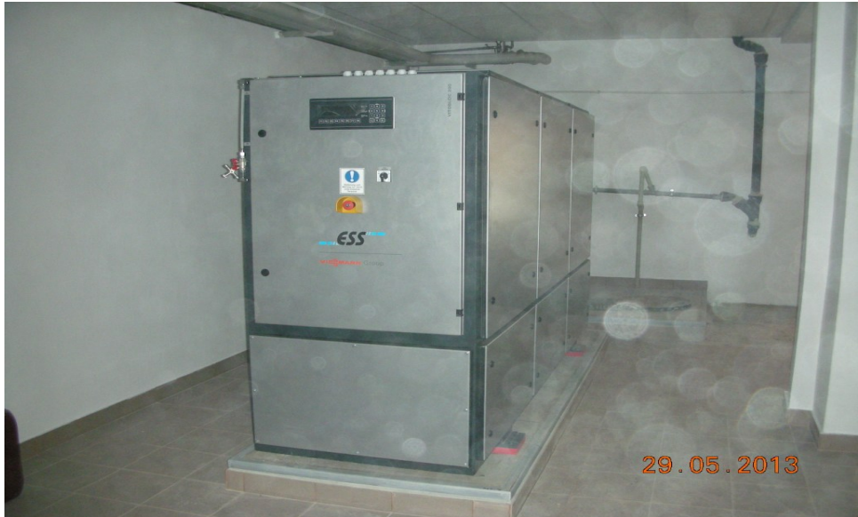
Rys. 3. Widok kotłowni i agregatu kogeneracyjnego 55 kW w minicentrum w Paniówkach
