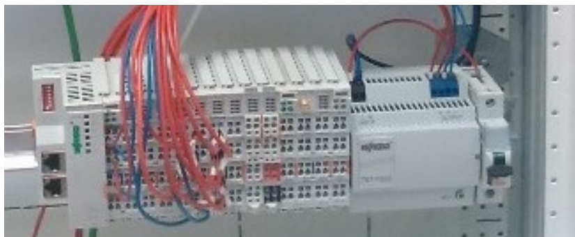
Rys. 2. Sterownik PLC WAGO-I/O-SYSTEM serii 750 zainstalowany w rozdzielnicy budynku
