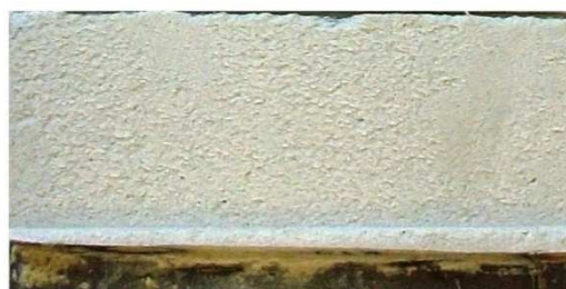
Zdj.4.2. Zniszczenie w kleju
