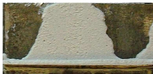
Zdj.4.4. Zniszczenie typu (a) plus (b)
