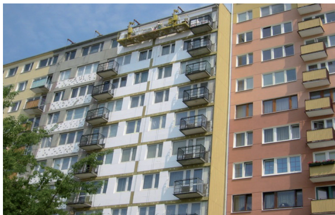
Ryc.2. System wielkopłytkowy, ocieplenie wykonano bez oceny stanu technicznego wieszaków, budynek w I. etapie ocieplono – ściany szczytowe i filarki – metoda lekka-sucha, w II. etapie ocieplono: belko-ściany na fasadach i wymieniono ocieplenie na filarkach międzyokienne – metoda BSO (styropian); zachowano detal podziału elewacji na filarki międzyokienne i belko-ściany); stan w 2003 roku
