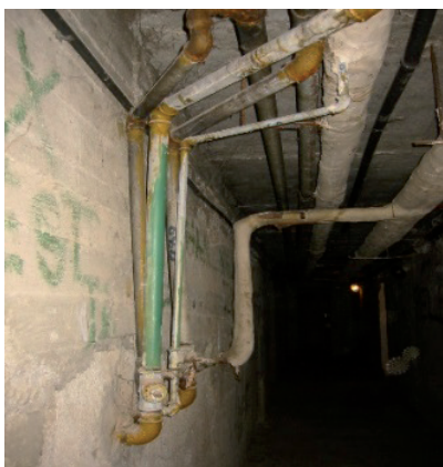
Ryc.9 Budynek prefabrykowany piwnice, stan instalacji c.w.u. i c.o.
