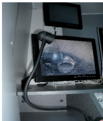
Ryc. 10 Kanalizacyjna studzienka rewizyjna, brak złożeń, podgląd kamerą wziernikową przez MPWiK
