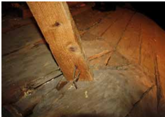
Fot. 8 Nieprawidłowo wykonane prace remontowe więźby, stwarzające zagrożenie dla konstrukcji obiektu, fot. A. Sapeta
