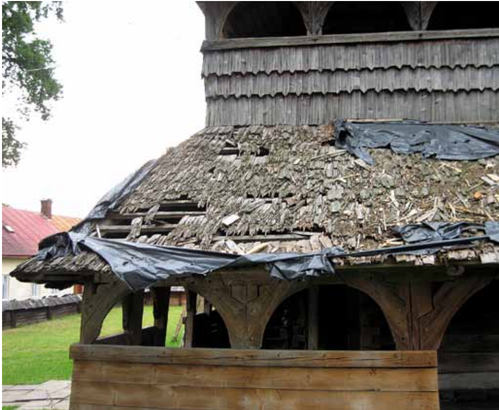
Fot. 4 Całkowite zniszczenie gontowego pokrycia – zagrożenie dla atrybutów materiał i konstrukcja, fot. A. Fortuna-Marek
