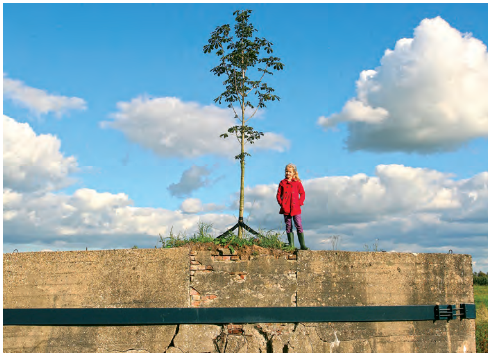
Il. 5. Symboliczne drzewo na uszkodzonym schronie, 2012 (BunkerQ)
