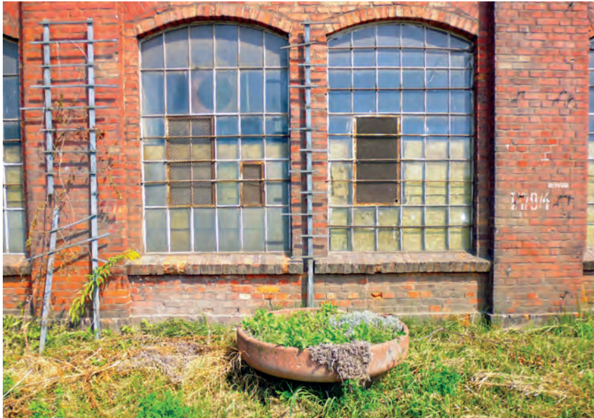
Fot. 3. Gdańsk, ul. Narzędziowców, budynek 48A w zespole hal zwanych „esami” byłej Stoczni Gdańskiej, powstały w końcu XIX w. na terenie ówczesnej niemieckiej państwowej Stoczni Cesarskiej. To zwyczajowe przezwanie wynikało z przeznaczenia tych hal po wojnie do licencyjnej produkcji spalinowych silników okrętowych napędu głównego, co oznaczono literą „S”. W latach 1960–1990 zbudowano 122 silniki. Wzdłuż fasady widoczne pozostałości ogródków wydzielonych z drabinkami pod rośliny pnące i płaską betonową donicą na kwiaty. Jest to szczególnie przykład wartości techno-estetycznej „w działaniu” in actu , który można interpretować jako element dziedzictwa niematerialnego – wyraz pragnienia uczynienia przemysłowego uciążliwego środowiska pracy bardziej przyjaznym człowiekowi. Fot. W. Affelt, 2015.
