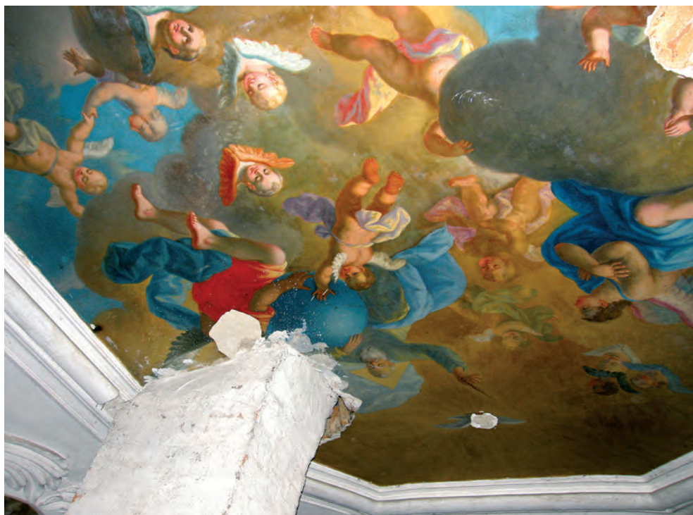
Fot. 7. Barokowe opactwo cystersów w Lubiążu. Po wtórnym użytkowaniu wnętrza pozostał przewód kominowy poprowadzony przez malowidło ścienne na sklepieniu. Fot. Ewa Świącka
