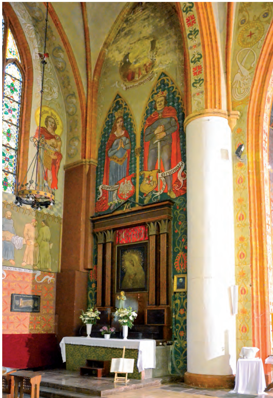
Ryc. 4 Boczna nawa kościoła. Ołtarz MB Ostrobramskiej z 1952 roku i polichromie z 1958. Na górze widoczne zniszczenia powierzchni malarskich wywołane zaciekami wody. Foto: autor
