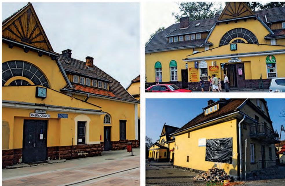
Il. 4. Stan dworca w 2011 roku. Na prawym dolnym zdjęciu widać uszkodzenia spowodowane uderzeniem samochodu. Źródło: archiwum Oddziału Gospodarowania Nieruchomościami PKP w Krakowie
