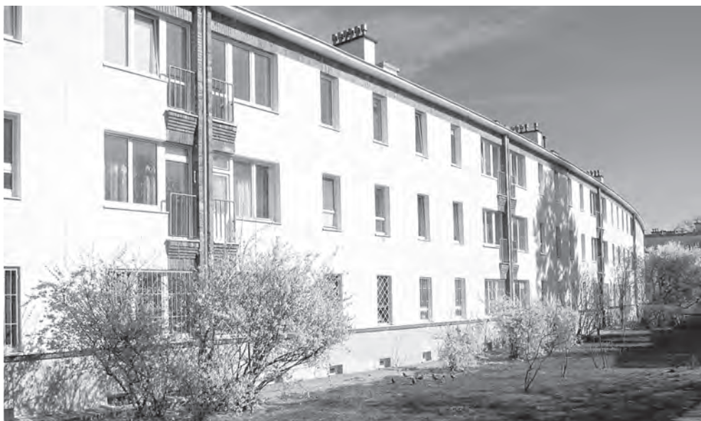
Fot. 2. Warszawa. IX kolonia WSM na Żoliborzu. Elewacja budynku A po zakończeniu prac renowacyjnych.
