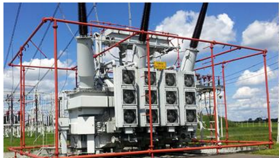
Rys. 1. Transformator sieciowy na stacji elektroenergetycznej „Plewiska” 400/220/110 kV z widocznym układem chłodzenia, [4]
