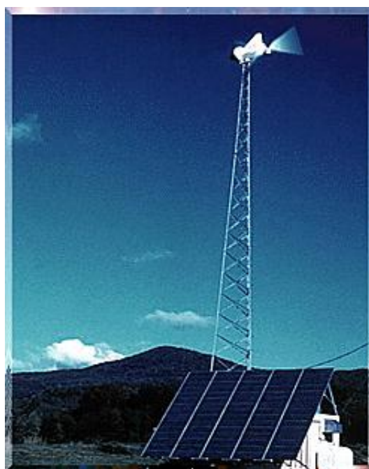
Rys. I.20. Widok systemu hybrydowego zasilającego stację meteorologiczną wysoko w górach [I.35]
