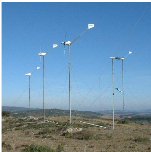
Rys.II.60. Farma wiatrowa składającej się z wiatraków o konstrukcji stalowej, rurowej z odciągami [II.9]
