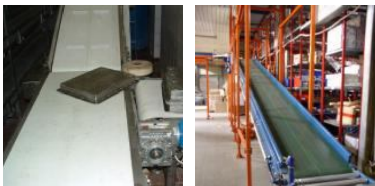
Rys. 1.9. Przenośniki taśmowe płaskie zabudowane przy regałach półkowych [19, 47]
