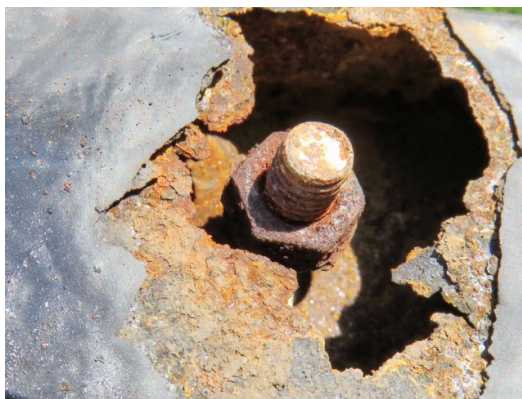
Fot. 1.4. Skutki korozji atmosferycznej konstrukcji stalowej
