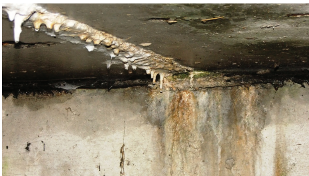
Fot. 1.6. Produkty korozji ługującej i węglanowej (Żaczek T. praca dyplomowa w PL)
