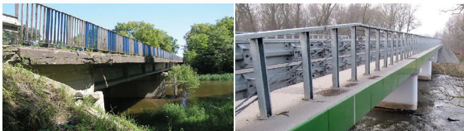
Fot. 1.5. Skorodowana cementowa płyta mostowa (z lewej), wyremontowana (z prawej) w Sernikach nad Wieprzem (Sołyga R., praca dyplomowa w PL, 2014)
