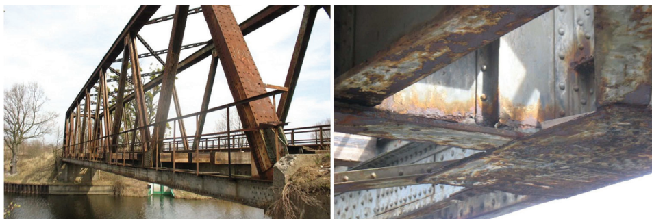
Fot. 2.1. Korozja atmosferyczna dźwigarów kratownicowych (z prawej), półki dolnej poprzecznicy (z lewej) mostu kolejowego nad Kanalem Gliwickim (M. Trykacz, praca dyplomowa w PL, 2013)
