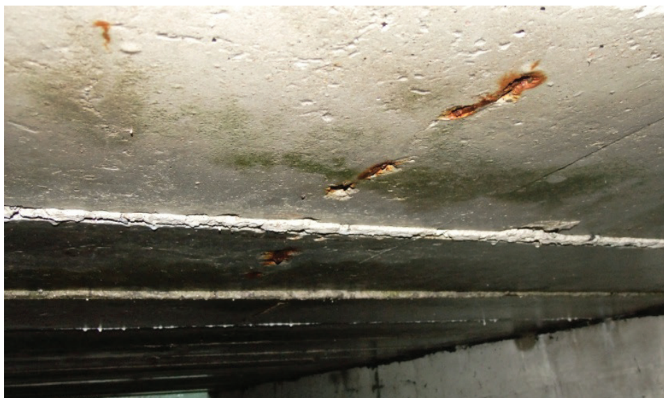
Fot. 2.4. Korozja pomostu żelbetowego (Żaczek T. praca dyplomowa w PL, 2013)
