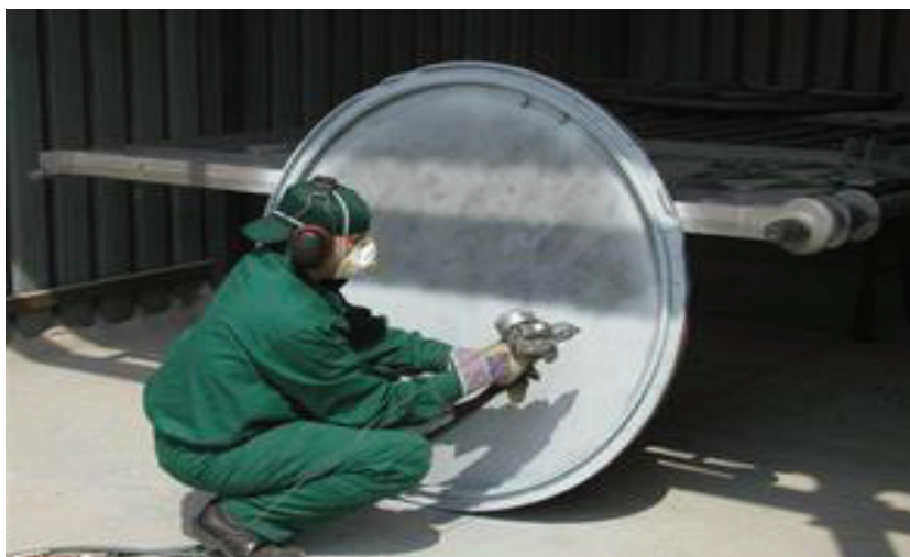
Fot. 2.3. Nakładanie powłoki cynkowej metodą natryskową (R. Sołyga, praca dypl. w PL 2013)
