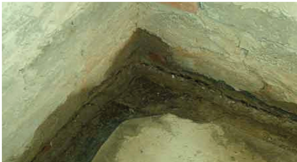
Fot. 4.1. Zawilgocenie ściany wskutek podciągania kapilarnego (Kielbasa K. praca magisterska w Politechnice Lubelskiej, WBiA, 2011)
